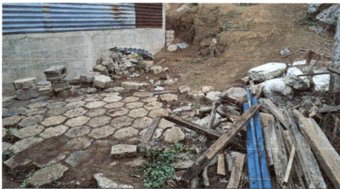
Foto 3: Cernido de paredes en área de edificio para cocina.
